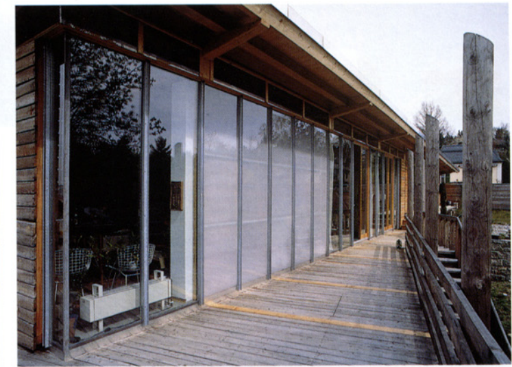
Die Fassade ist nach wie vor das klassische Einsatzgebiet der transparenten Wärmedämmung.
